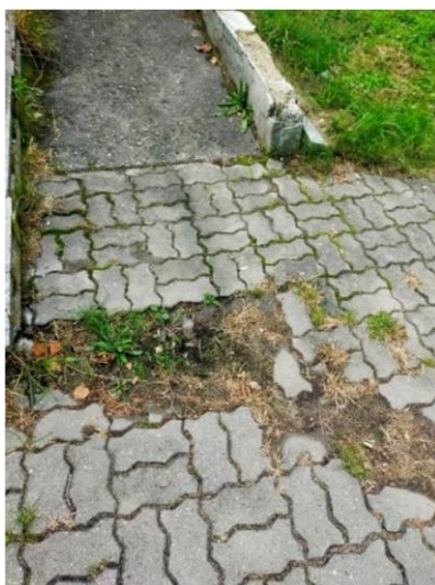
Zdjęcie nr 16: Uszkodzona nawierzchnia przed pochylnią
